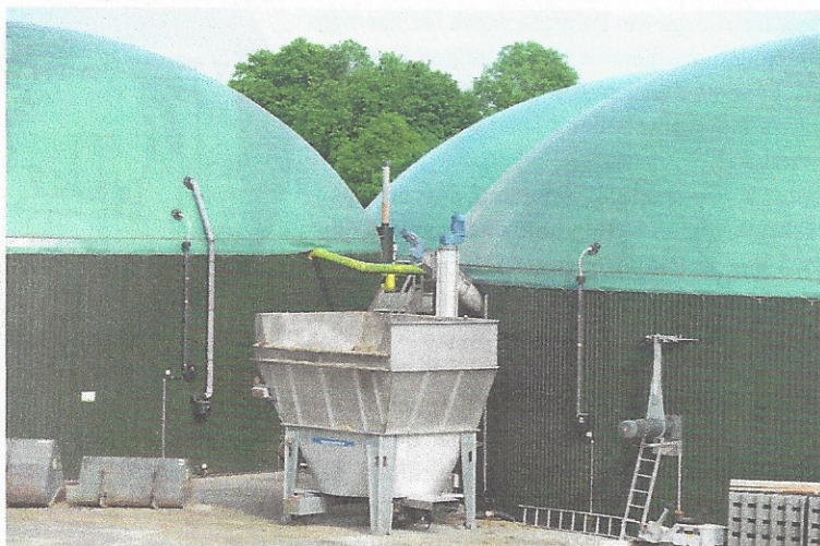
Blick auf den Feststoffdosierer der Biogasanlage der Bioenergie Fargau GmbH & Co KG.
